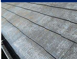
塗膜劣化・色あせ
