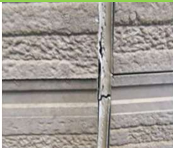
コーキングの劣化
