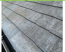
塗膜劣化・色あせ
